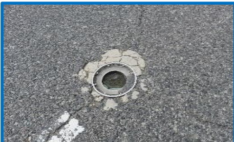
交差点のグランドライトの破損
